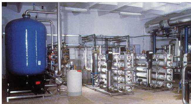
Fordított ozmózis berendezés és vízelőkészítése (vízlágyító és aktívszén szűrő berendezés)
