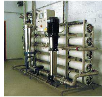
20 m 3 /h teljesítményű fordított ozmózis berendezés
