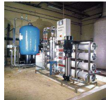
8 m 3 /h teljesítményű fordított ozmózis berendezés
